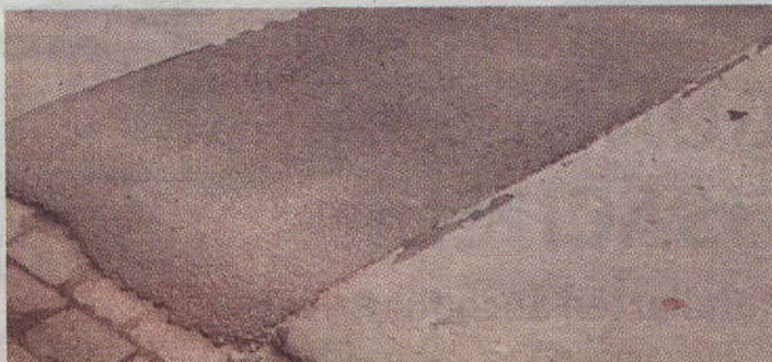
Ein Blick auf die Stedinger Straße zeigt die vielen Ausbesserungen
